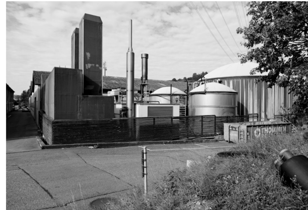
Die Biogas-Anlage von «BioPower» Nordwestschweiz.
