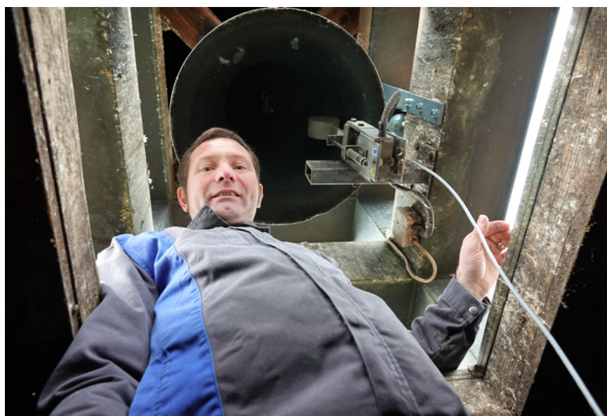
Andreas Sägeser hat den Aussenhammer revidiert und wieder in Betrieb genommen. Der Innenhammer wurde hingegen demontiert. Bilder Valentin Zumsteg
